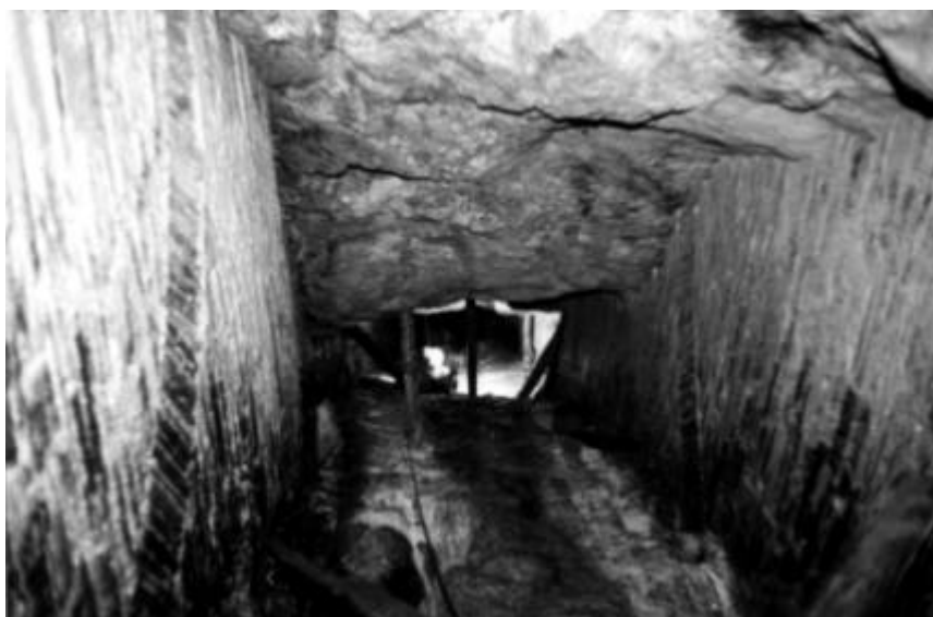
Abbildung 112: Schachtmauerung als Scheibenmauern Foto: privat Blick von unten nach oben im tonnlägigen Schacht mit Blick zum Liegenden. Der Schacht ist im Gang aufgeföhren und links und rechts mit Scheibenmauern vom Gang bzw. Abbau getrennt, Hangendes und Liegendes werden durch das Anstehende ohne Ausbau gebildet
