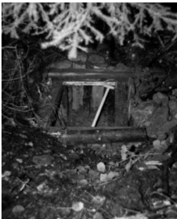
Abbildung 115: Befahrerschurf auf einen Foto: privat Schacht
